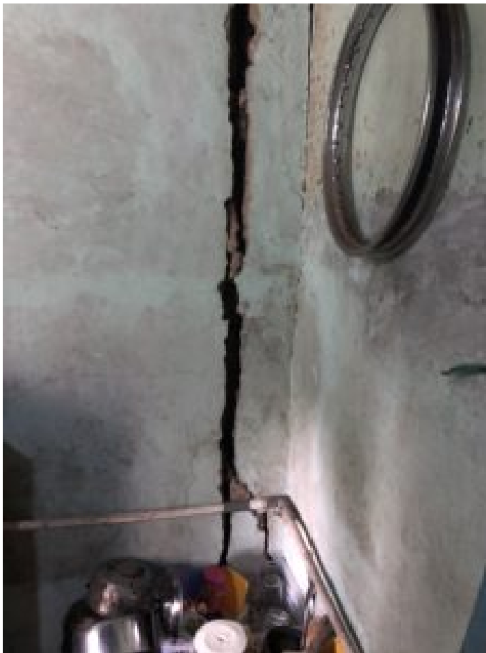
Risse verursacht durch die Sprengungen. © Joanna Klabisch
