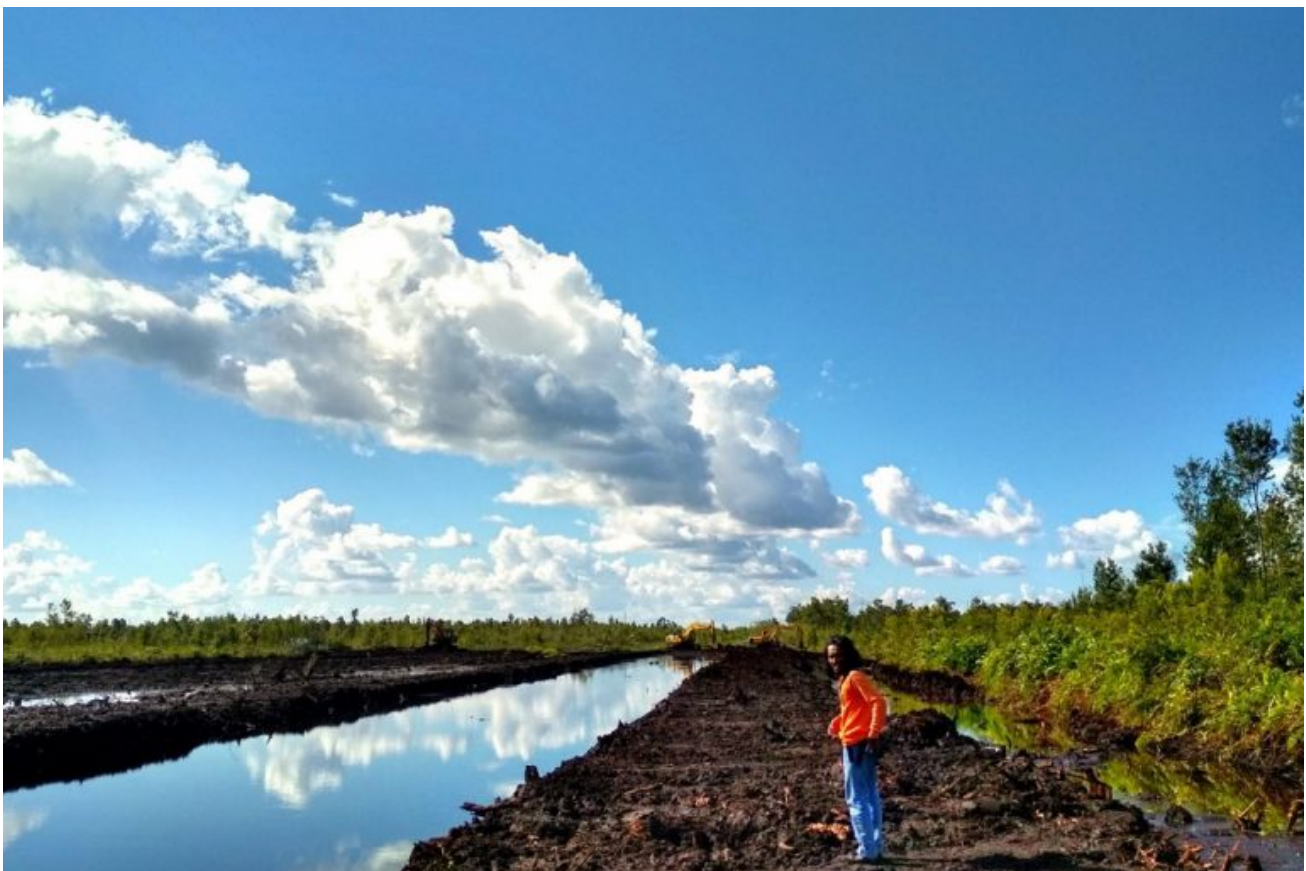
Der Kanal in Pulang Pisau wird blockiert © Indra Nugraha/Mongabay Indonesia
